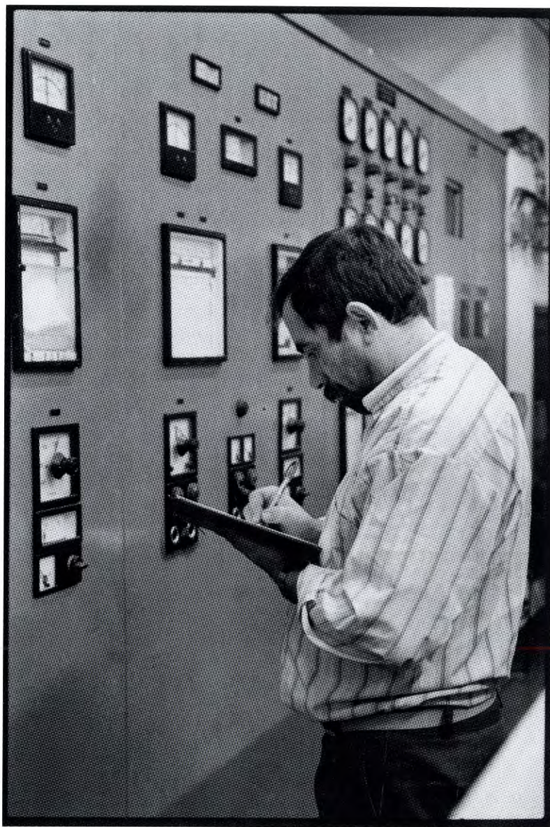
15) Operador a efectuar leituras e registos relativos aos cowpers do Alto Forno, junto aos painéis do sistema
